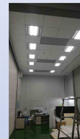
採用高效率 LED 照明
