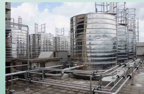
熱泵熱水供應水塔
