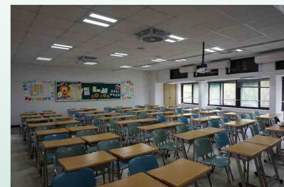
教室節能 LED 燈具節能電扇一級節能冷氣
