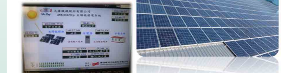
太陽能發電系統
