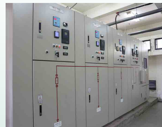
高壓電力節能改善工程
