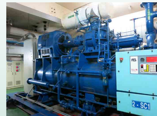
汰換儲冰冷凝系統
