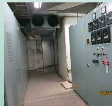
變電站改設夜間通風降溫節電
