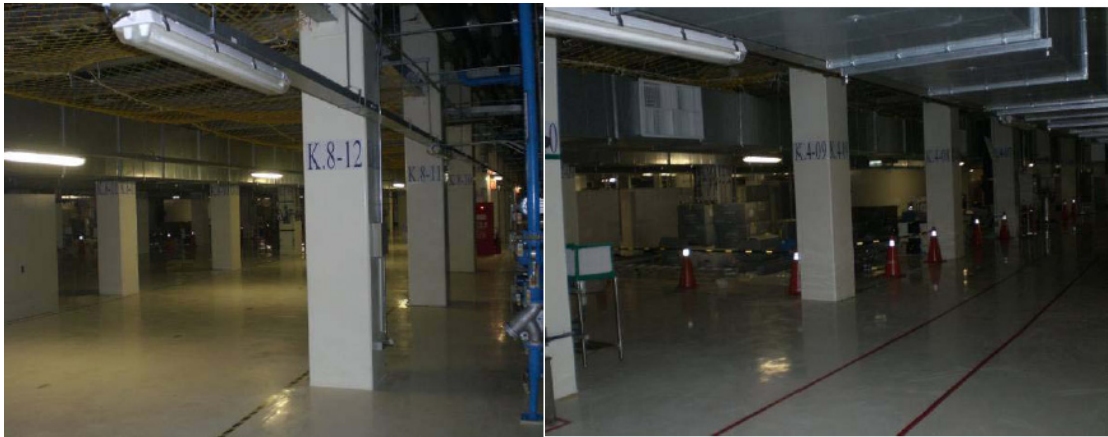
無塵室 Subfab 區域照明燈具減量
