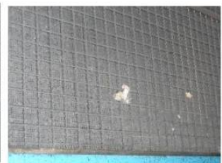
高壓馬達運轉空氣過濾網堵塞情形 LOAD SIDE
