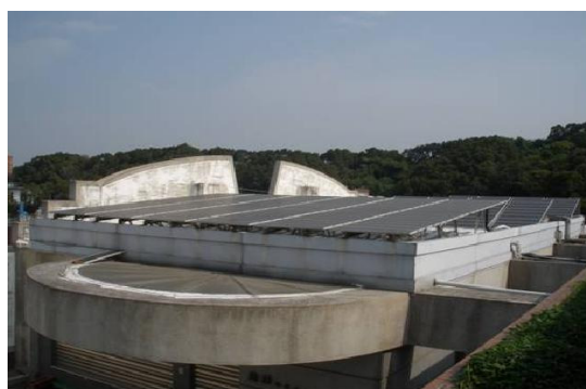
太陽能發電系統
