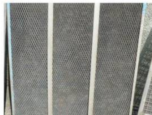
空氣過濾網清洗後仍堵塞嚴重
