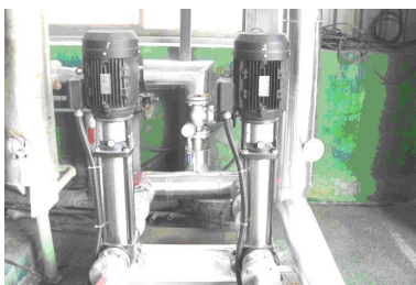
2. 給水泵浦改善 給水泵浦 5.3HP
