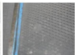
空氣過濾網破損嚴重不堪使用
