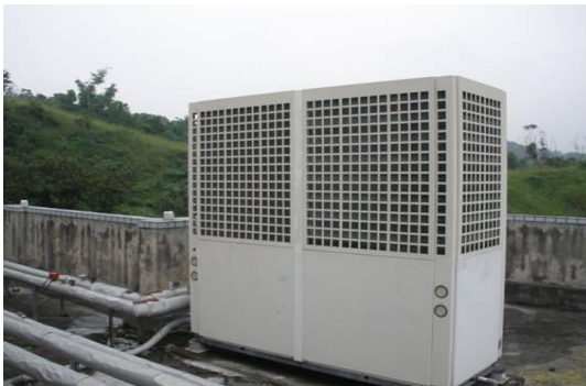
二期宿舍熱泵系統
