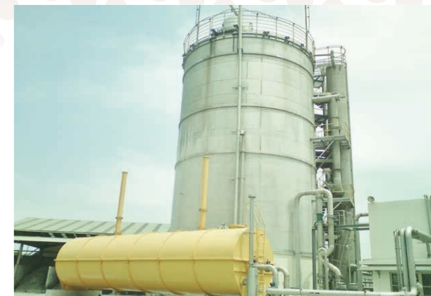
廢水處理增設厭氧前處理及沼氣回收再利用
