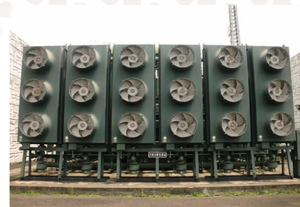
變壓器冷卻系統節能改善
