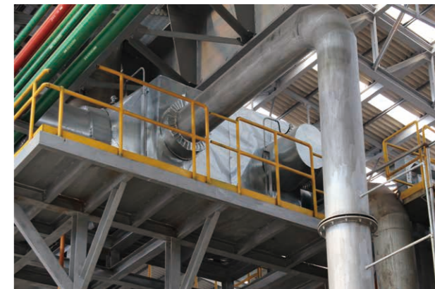
鋁胚均質化爐燃燒系統增設廢熱回收熱交換器
