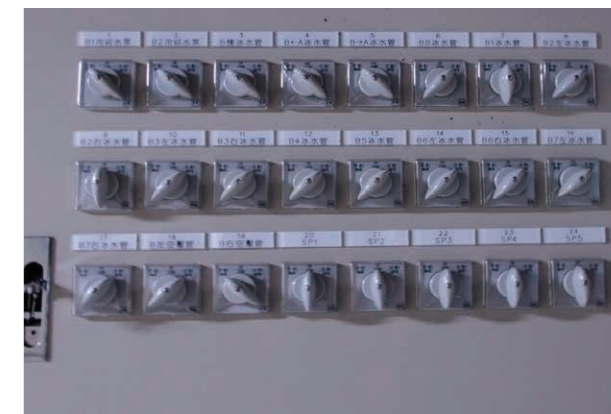
IEN 控制冰水電動閥迴路照片
