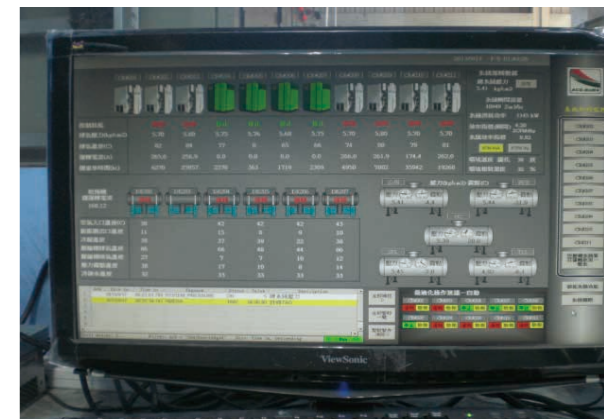
空壓機監控系統
