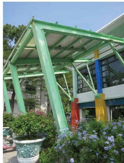
圖書館太陽光電系統外遮陽裝置
