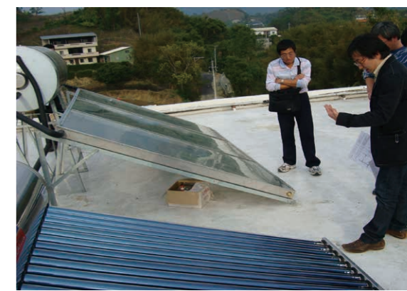
屋頂太陽能熱水器供學生洗碗及廚房使用
