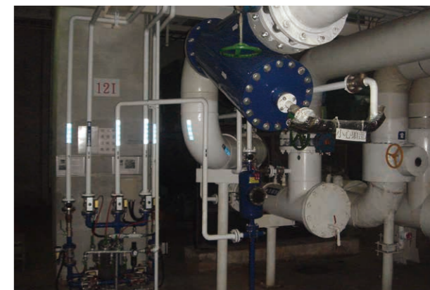
冷凍機冷凝器自動清洗節能
