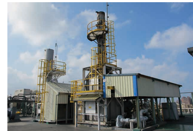
製膜廠焚化爐
