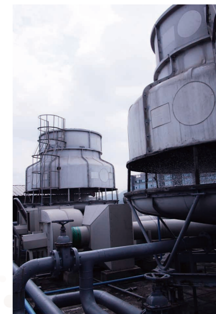
中央空調系統冷卻水塔併連照片
