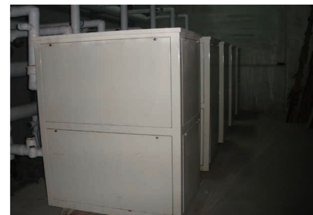
休閒會館 SPA 熱泵冷源回收系統
