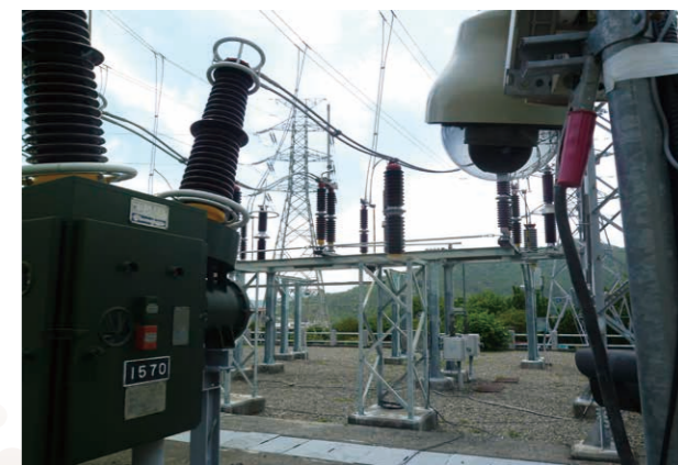
楓港變電所遠端監視操作
