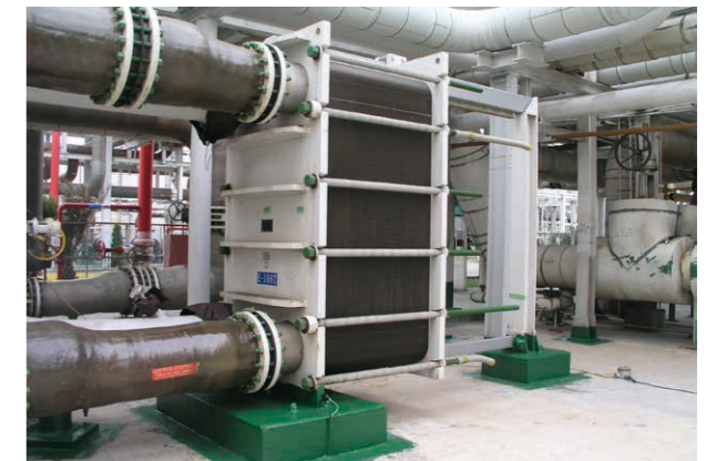
淡鹽水熱回收系統 - 熱交換器
