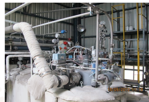
熱媒鍋爐燃油改天然氣
