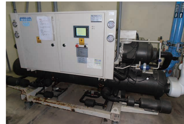
藝文中心高效率冰水主機
