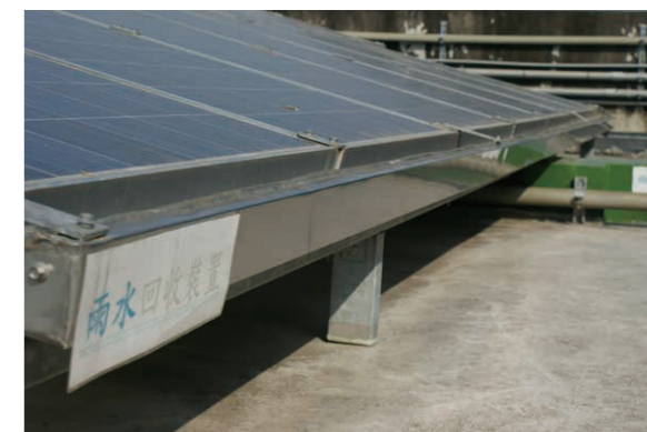
屋頂 - 太陽能設施 (含雨水回收裝置)
