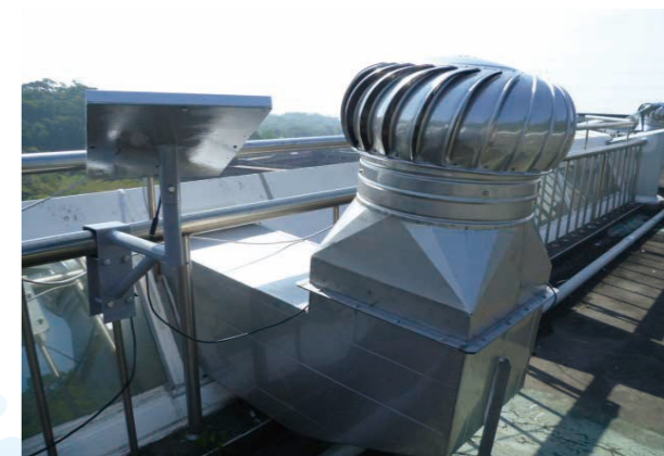
圖書資訊大樓熱浮力通風系統
