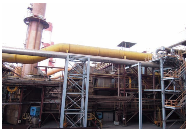
使用輔助燃料焦爐氣鍋爐
