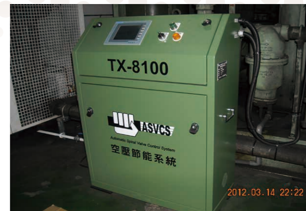
空壓陣列 (系統) 效能優化 - 空壓機電控螺旋系統
