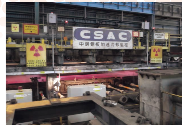
鋼板線上加速冷卻設備
