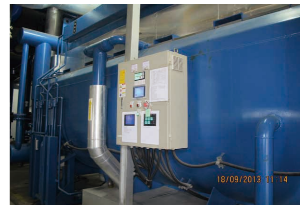
吸收式冷凍機
