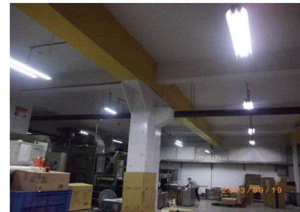
T8 燈具汰換為 LED 燈具整體節能成效
