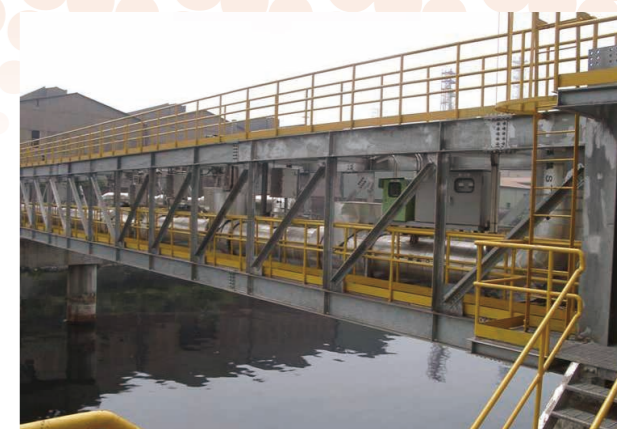
區域能源整合外售中石化公司蒸汽管線及管橋
