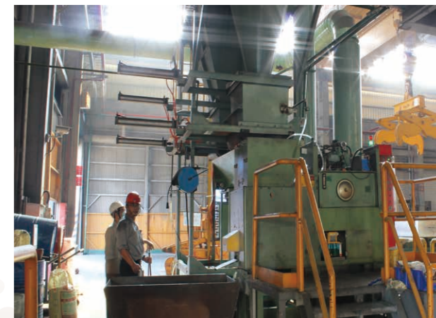
鋸屑壓塊機，壓塊直接投入熔化爐回收
