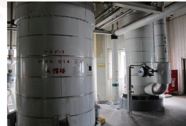
酯化蒸餾塔節能改善
