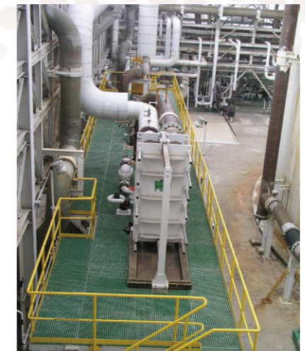
淡鹽水熱回收系統 - 操作架台
