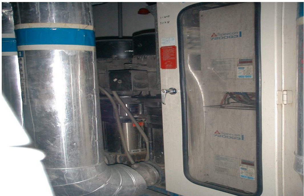
省能方法：熱水泵採用恆壓變頻器，減少電能耗用。 相片 6.3-18 鍋爐系統
