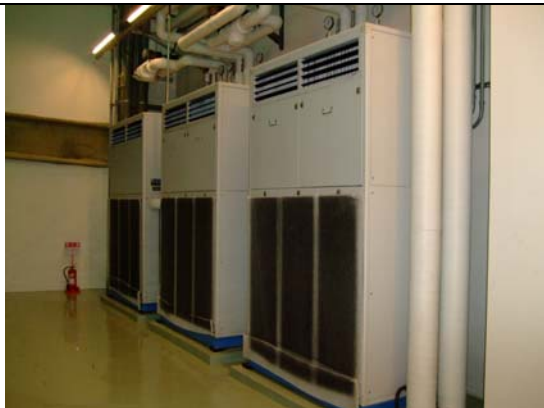
配電室冷房空調系統 (空調箱隨變壓器負載高低所產生之熱負荷，加以配合自動控制調整，節約空調耗電)
