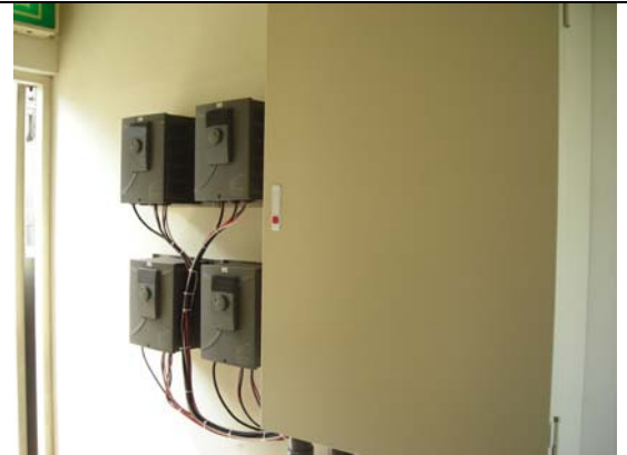
冷卻水塔風車變頻器 (隨空調主機負載及氣候變化， 調整風車轉速節能用電)
