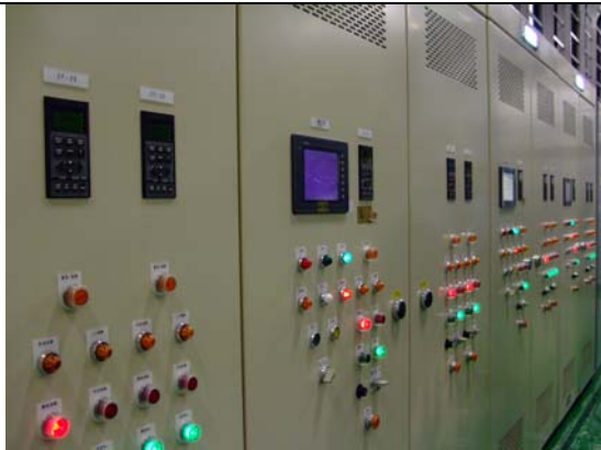
高壓配電盤(人機介面顯示)
