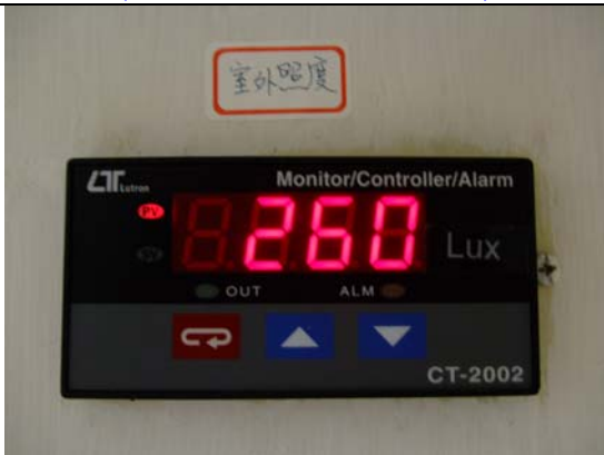
室外照明採用照度控制器 (利用室外照度計管理調配商場點燈數量)
