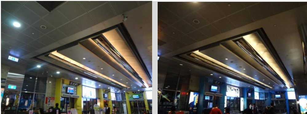
圖 8.2-6 轉運站全般照明改善後實照
