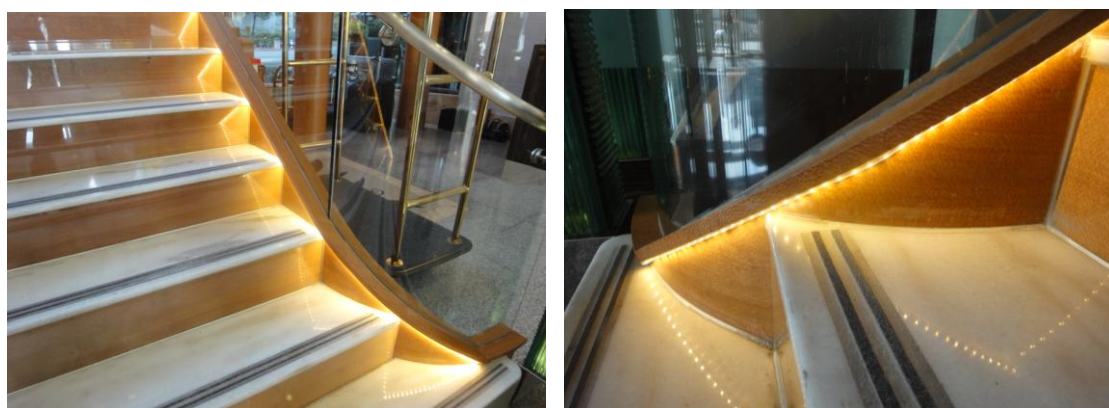
圖 5.3-8 樓梯照明採用 LED 燈源
