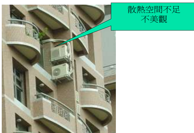
圖 5.2-2 室外機散熱通風空間不足且不美觀之安裝
