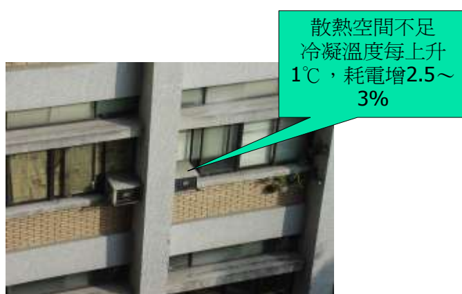
圖 5.2-1 冷氣機散熱通風空間不足之安裝
