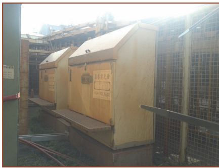
中鋼電力系統 RM-194-11.4KV饋線
