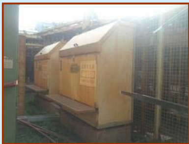
中鋼電力系統 RM-194-11.4KV饋線
