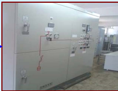
#2 SS 電氣室 11.4KV高壓控制盤
