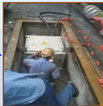
碼頭岸邊 11.4KV Shore Connection Box
