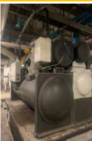
汰換儲冰空調系統 節電678,600kwh/ 年 減碳361噸/年
