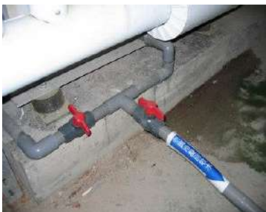
空調系統排放水回收
