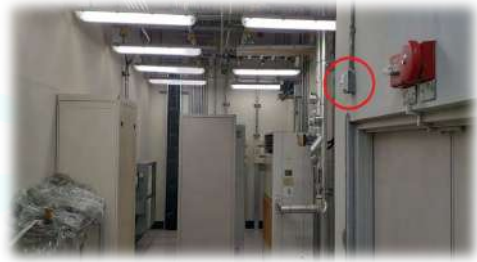
原空調溫度感測器安裝位置(前)
