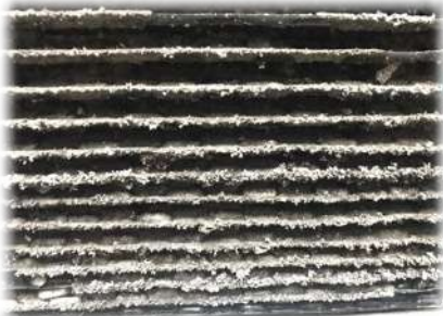
散熱材汰換前
