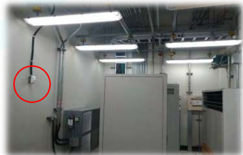
空調溫度感測器安裝位置優化(後)
