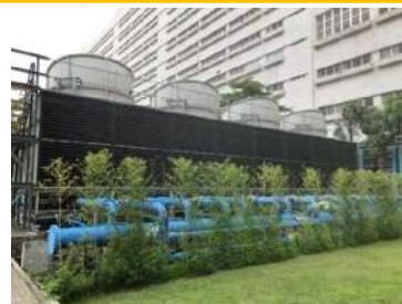
汰換冷卻水塔 節電21,5914kwh/年 減碳120噸/年
