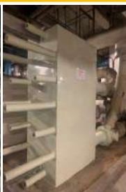
板式熱交換器汰換 節電622,577kwh/ 年 減碳331噸/年
