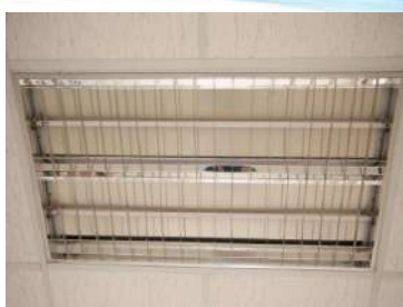
節能燈具汰換 節電172,645kwh/年 減碳95.6噸/年
