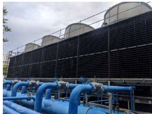
#1.2.5冷卻水塔外觀
