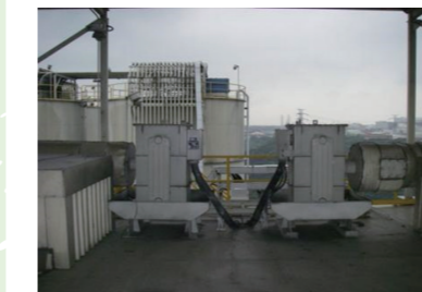
原第一、二室傳統變壓室
