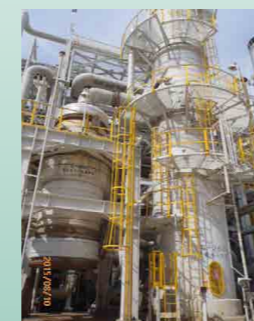
節蒸汽改善_C260 進料水溫度提升至 110 度 C
