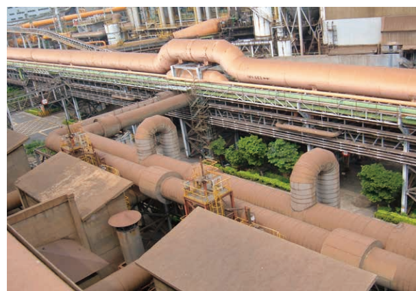
動力工場鼓風機冷鼓風管網
