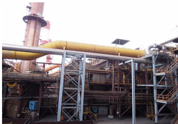
使用輔助燃料焦爐氣鍋爐
