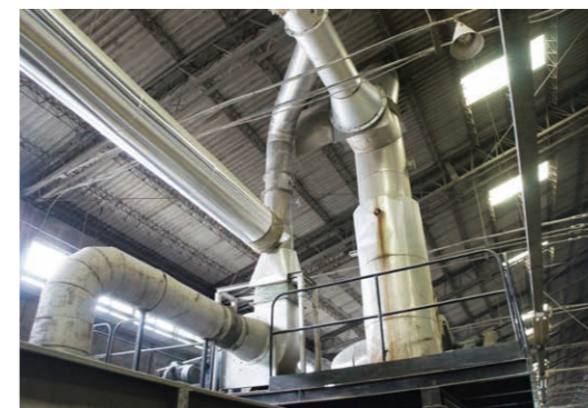
燒成窯後煙道廢熱回收
