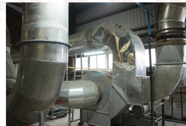
燒成窯前廢熱煙道熱回收
