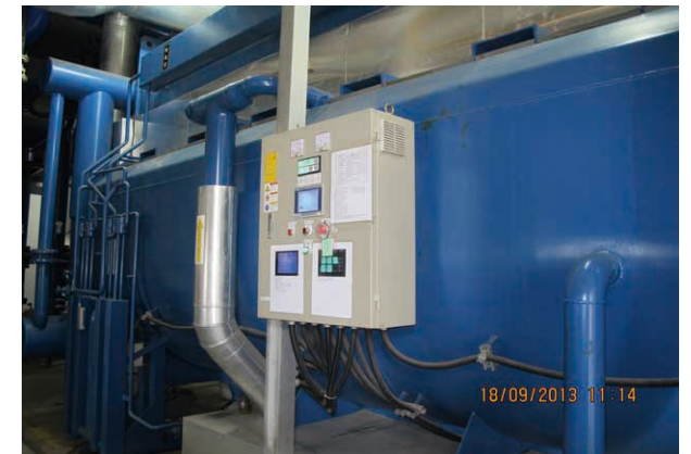
吸收式冷凍機
