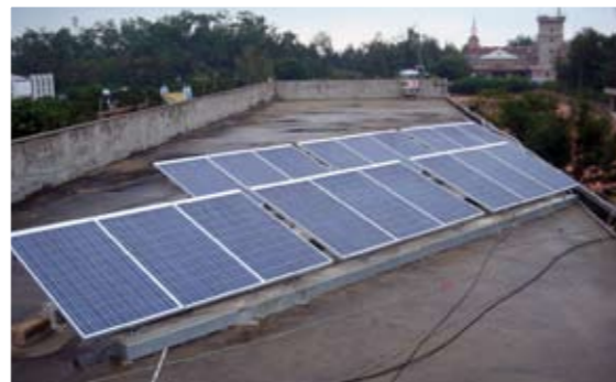
位於本校樓頂太陽能板
