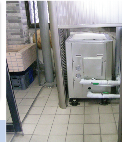
第一宿舍超導熱泵-熱泵主機
