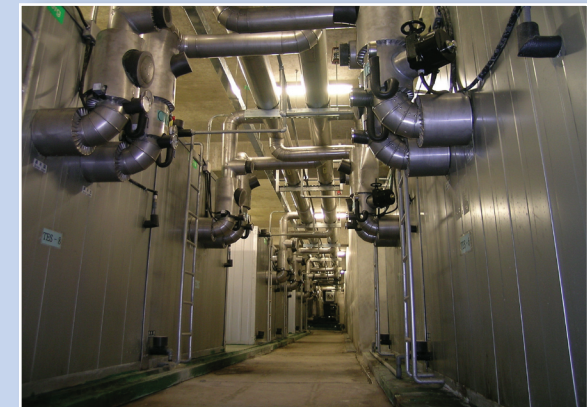
七館空調-儲冰系統
