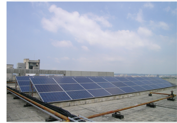
七館太陽能光電發電-光電板
