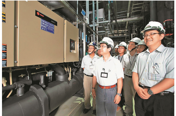
台積電三廠裝設多功熱泵(Heat Pump)取代電熱鍋爐，將 ESCO 訴求的創新節能做最佳的應用。
