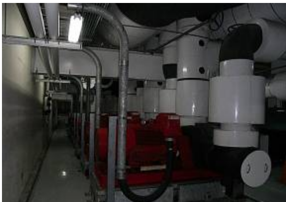
2. 冷凍水輸出泵浦變頻器
