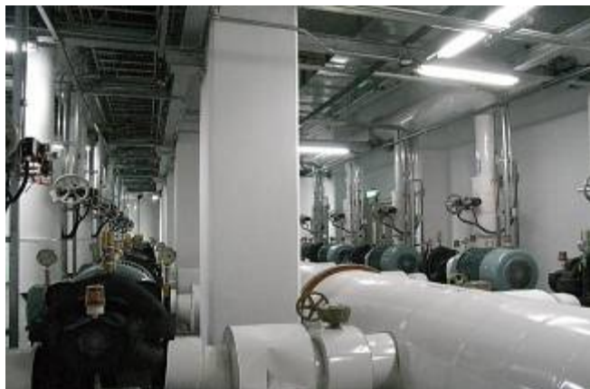
2. 製程冷卻水泵浦變頻器
