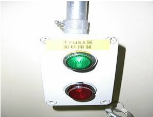
1.FAB-1 truss area照明開關關閉前
