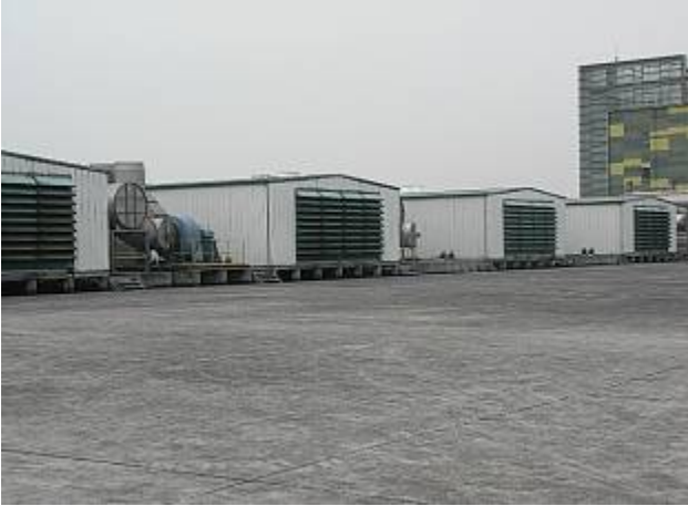
2.MAU空調箱變頻器照片
