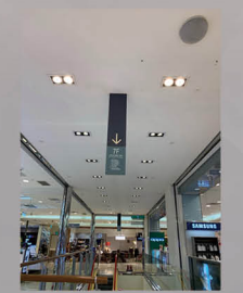
走道照明使用情況
