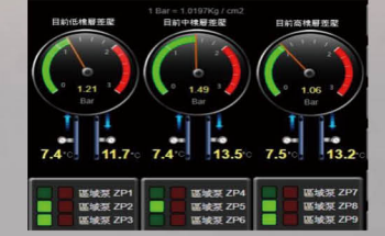
利用冰水分區系統壓力差調整區域泵數量及變頻器轉速
