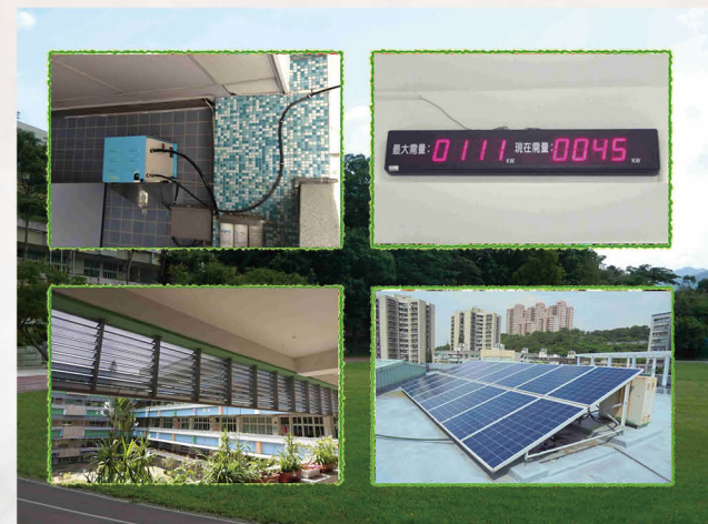
智慧校園節電措施 - 降溫水霧、智慧節電、節能遮陽板、太陽能發電設施
