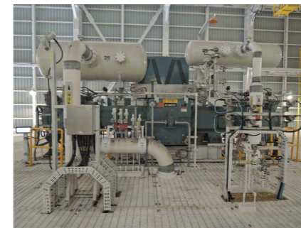
氫氣單元甲烷氣縮機
