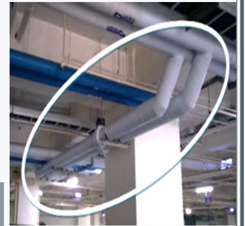
冰水管路連通
