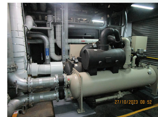
汰換使用高效率雙葉輪離心式冷凍機節能
