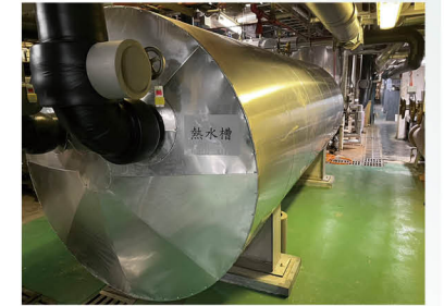
熱泵主機熱水系統
