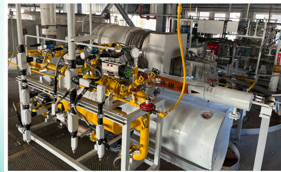
熱媒鍋爐燃料變更為低碳能源
