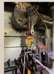
下預熱區的燃燒器加裝 on/off 閥作數位控制
