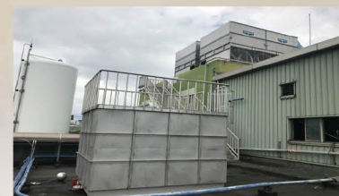
新的蒸發冷凝器
