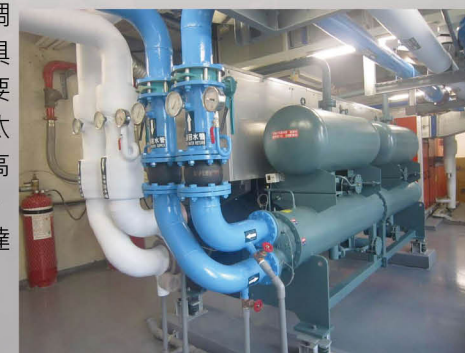
汰換之變頻冰水主機
