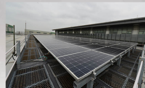
屋頂設置太陽能光電
