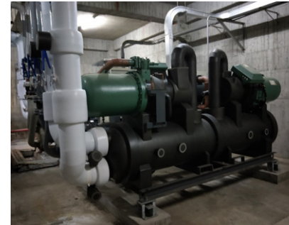
圖書資訊大樓更換高效率變頻冰水主機及建置智慧化節能控制系統
