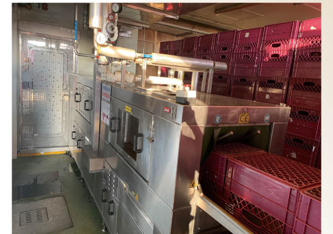
洗箱機能耗改善
