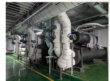
達到美國冷凍空調學會 (ASHRAE) 中央空調主機房系統運轉效率 - 卓越等級
