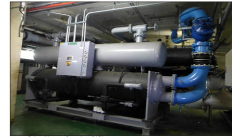
更換儲冰主機
