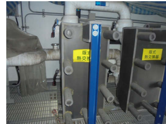
廠務中央供應切割機冰水節能專案
