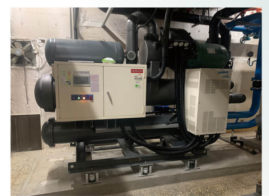
第二教研大樓冰水主機更新
