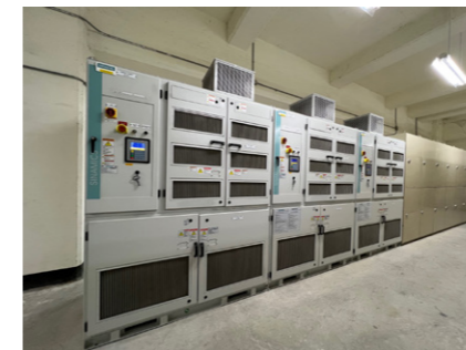
1&2K 冷卻機風車改變頻控制 (中壓)
