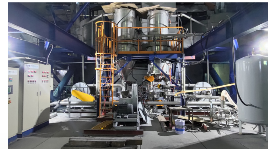
新除酸藥劑設備
