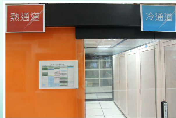
電腦機櫃換裝櫃內循環式空調機櫃及建置冷熱通道
