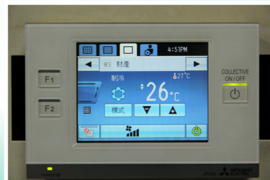
多聯變頻冷氣機室內控溫
