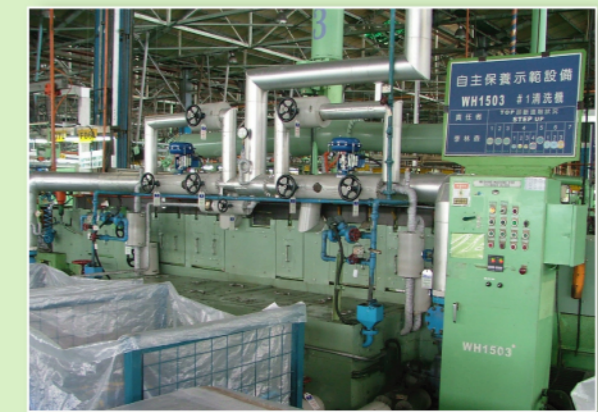
引擎場NO.3清洗機溫控節能
