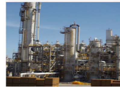
再生塔、接觸塔及預飽和塔
