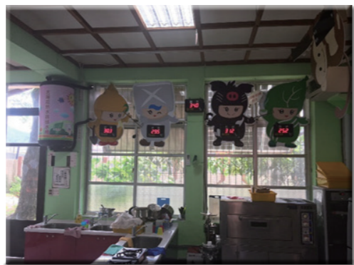
電力監控系統
