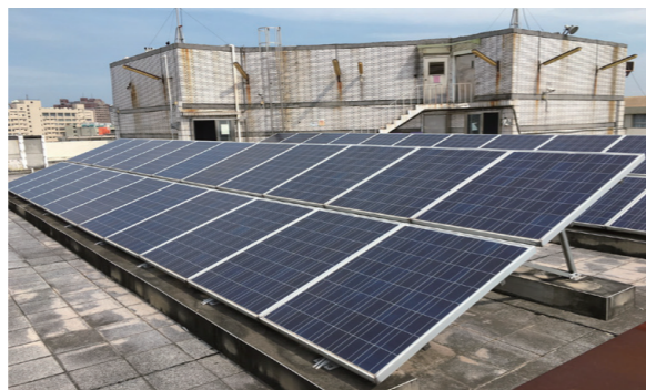
土木系設置 12kW 太陽光電系統
