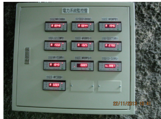
醫院增設電錶有效管理用電
