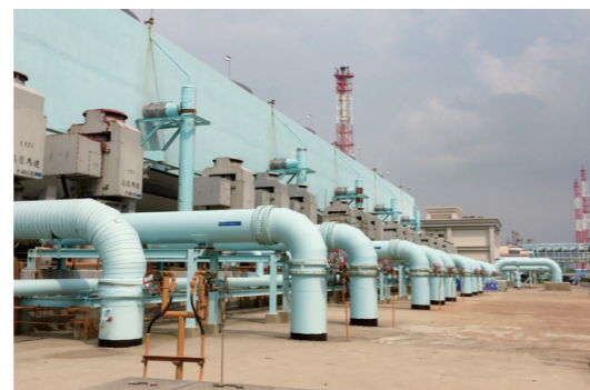
冷卻水塔節電 (高壓循環水泵)
