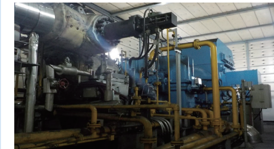
改善後：汽輪發電機組 (背壓式) 產生電力及蒸汽
