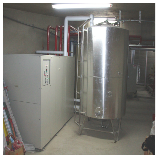
圖 5.1-5 冷凍冷藏主機之熱回收控制閥及供應熱水使用【13】
