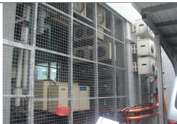
冷凍冷藏機組與散熱器
