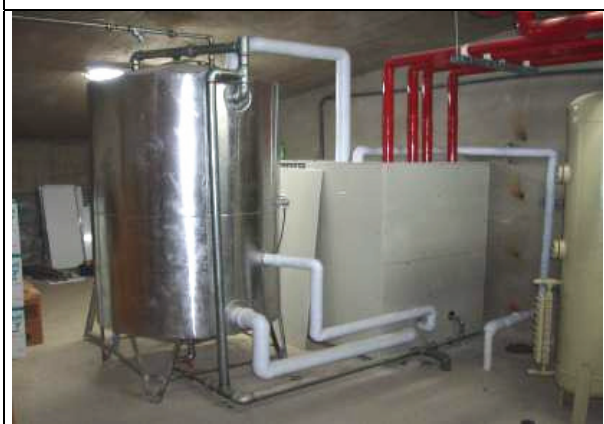
冷凍冷藏主機熱回收 熱水儲水桶與保溫管路
