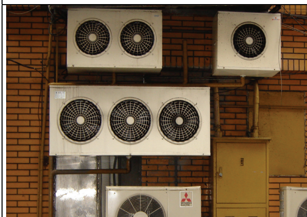
冷藏主機散熱器熱源外移
