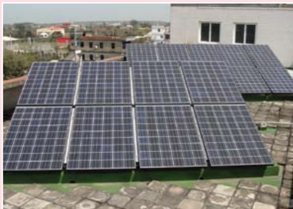
太陽能發電板
